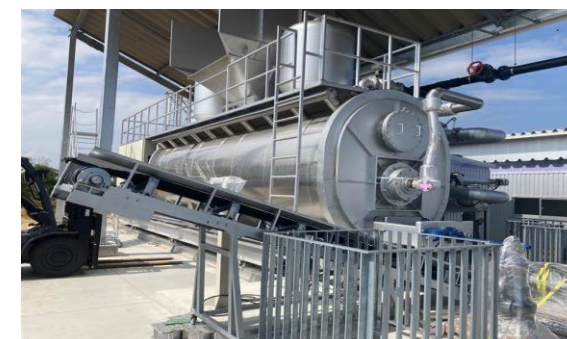
▲バイオマス廃棄物処理システム
